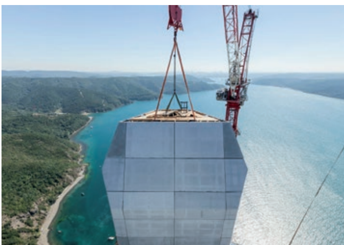
Das maximale Plattengewicht von 110 kg/m 2 war nur mit einer GRID-Bewehrung von solidian zu erreichen.
