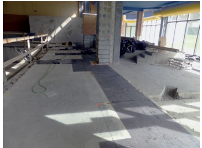
KKS-Carbonbeton in Rissbereichen eines Hallenbades, Titananoden an den Stützen. Foto: Koch
